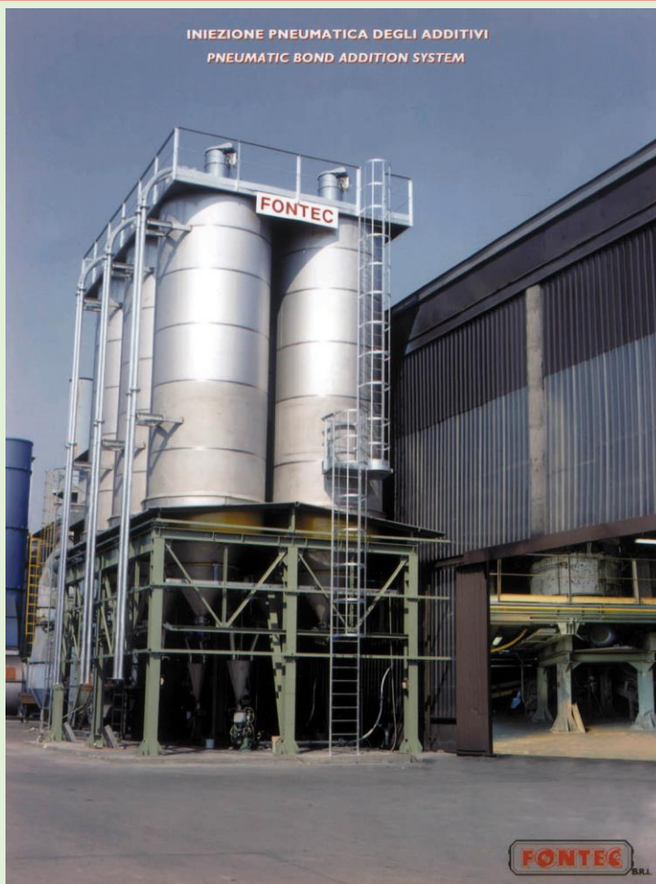
SILOS ESTERNI DEPOSITO ADDITIVI PER INIEZIONE PNEUMATICA A DISTANZA
